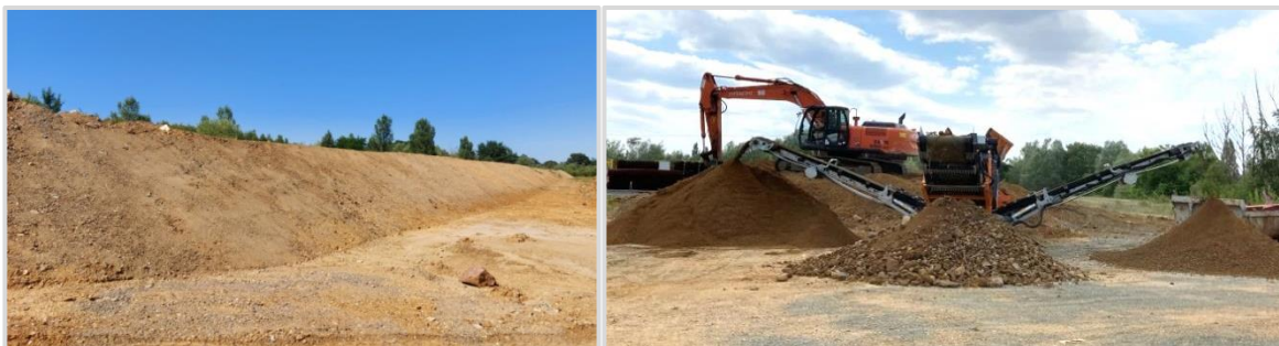
Photo 4 : exemple de merlon périphérique et activité de broyage et concassage de gravats et produits minéraux.
